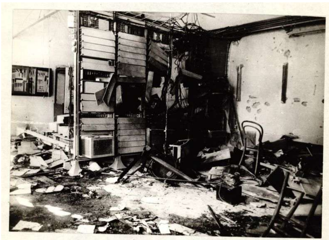
Slika 11. Uništeni uređaji zagrebačke automatske telefonske centrale nakon partizanske diverzije 14. rujna 1941.
